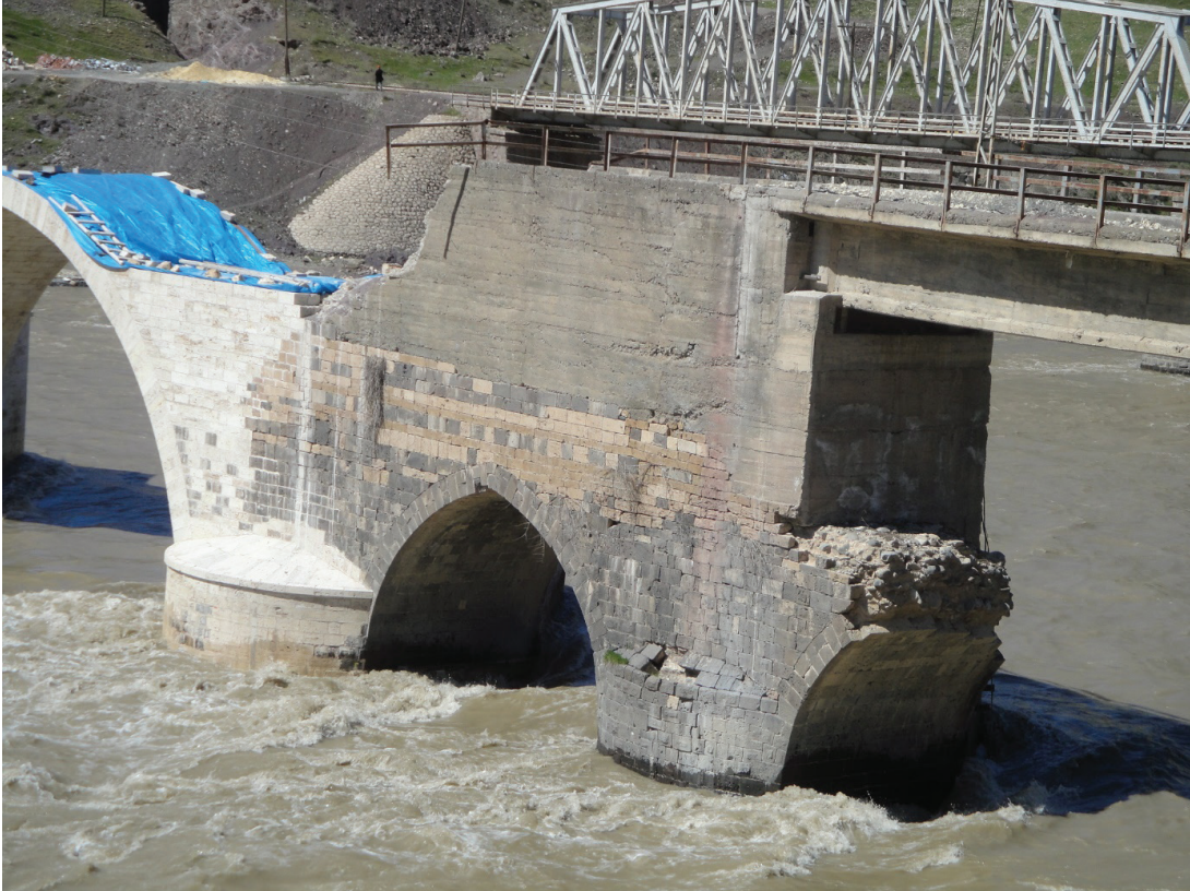
Şekil 9 Palu Köprüsü’nün 2010 yılına ait görüntüsü. Sağ ayak ve kemer kısımlarına bakıldığında birden farklı malzemeyle onarımların yapıldığı açıkça görülmektedir. Bu onarımların her biri farklı zamanlara ait olmalıdır. Kullanılan malzeme ve inşaat teknikleri incelenerek tarihlendirilmeye gidilmesi bilimsel açıdan önemli veri kaynağı olacaktır.
